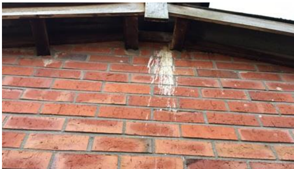
Schijfsporen van spreeuwen aan de buitenkant van een van de te slopen gebouwen. Dergelijke schijfsporen zijn een duidelijke aanwijzing op een nestplaats onder de golfplaten.
