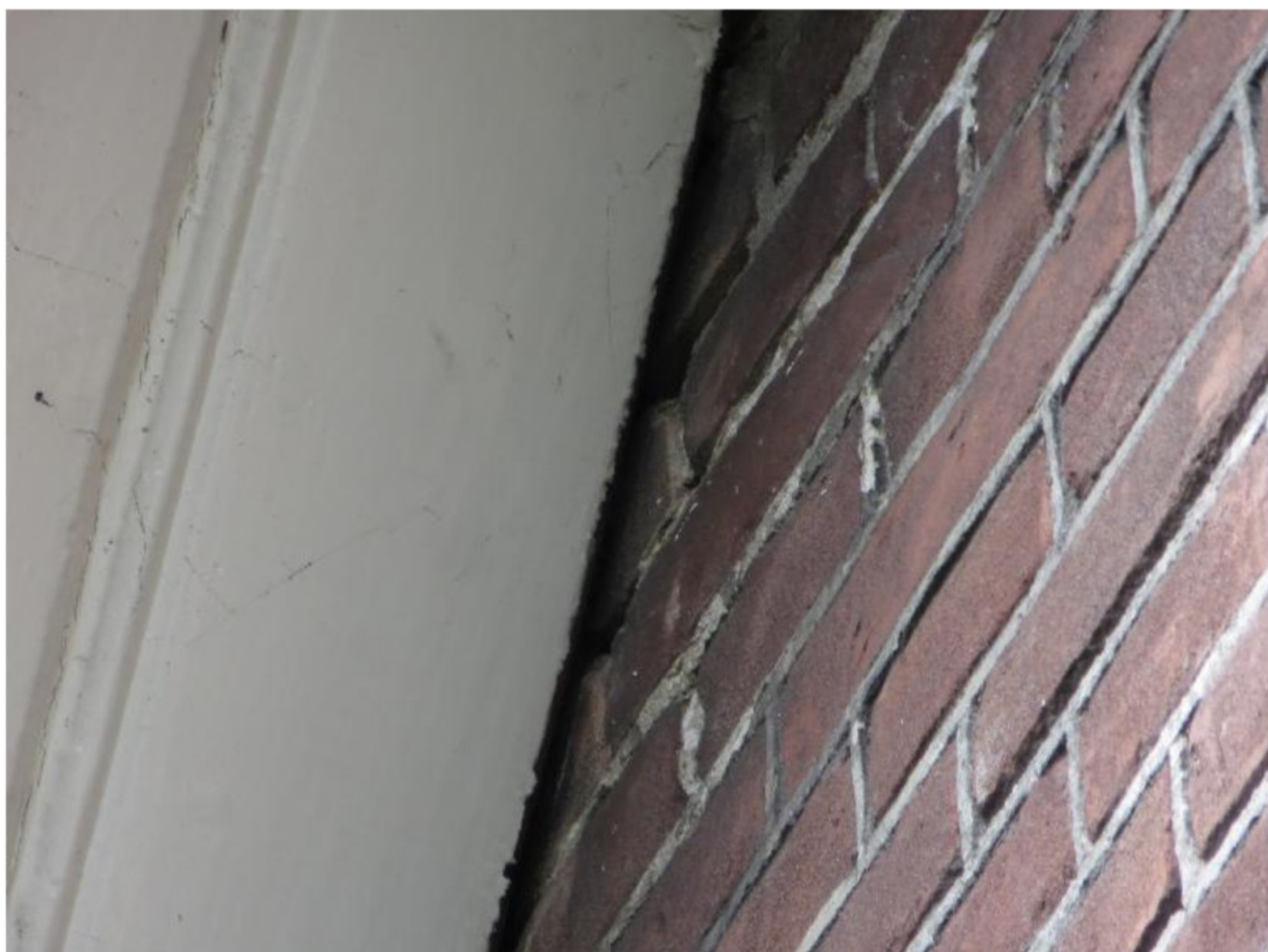
Foto 13: Kieren achter betimmering (gebouw 5), mogelijke toegang voor vleermuizen.
