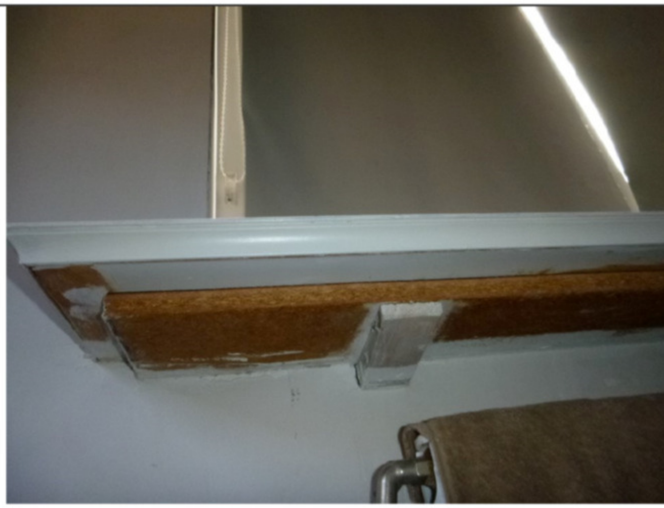
Foto 12: onderzoek onder vensterbanken.
