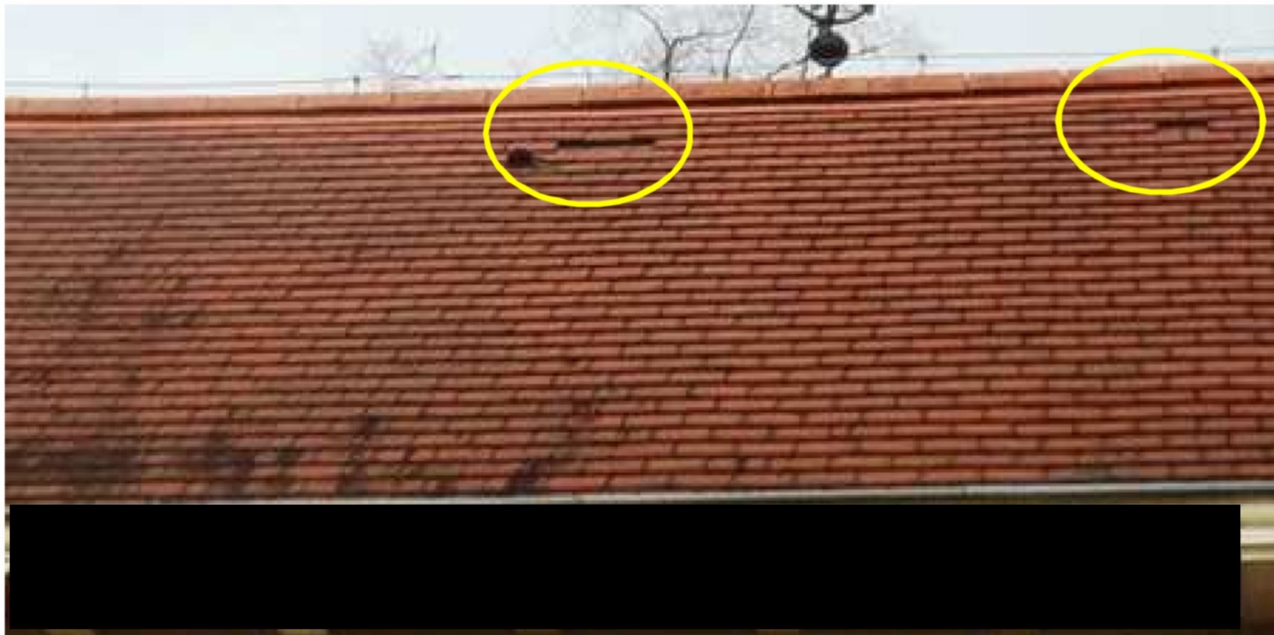
Openingen in het dakvlak door ontbrekende dakpannen. Deze openingen stellen vleermuizen in staat het dakvlak te betreden.
